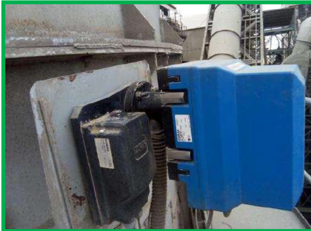
Slag mill Opacity Meter
